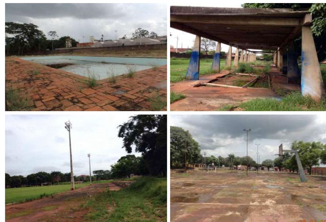
Instalações do Centro Comunitário em estado de conservação deteriorado impedia o uso da população. Em sentido horário: Piscina, campo de bocha, pista de atletismo e quadras poliesportivas.
